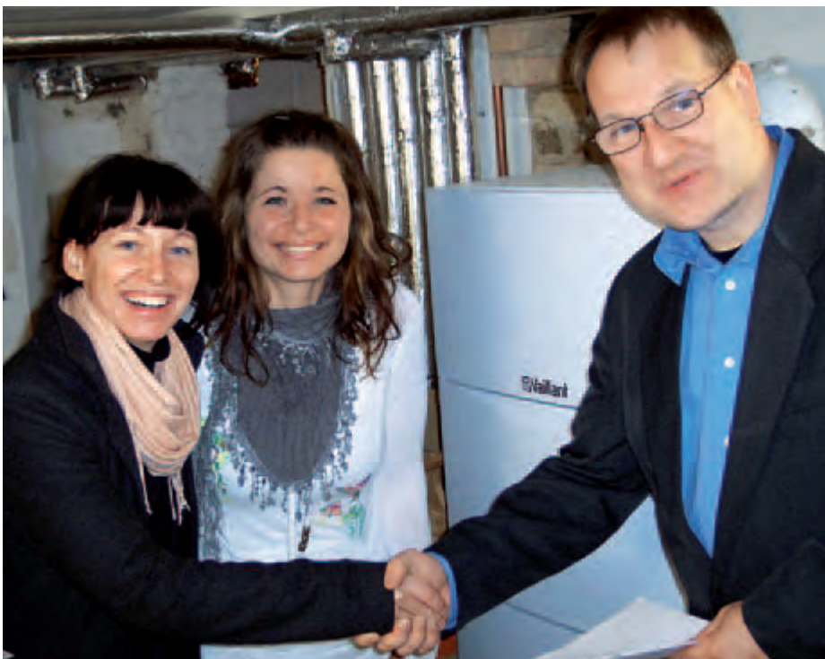
Christiane Arndt (Mitte) bei der Übergabe der neuen Heizungsanlage. Sie hat einen Wärme-Service-Vertrag mit der SBL abgeschlossen und kann nun den Vollservice genießen.
